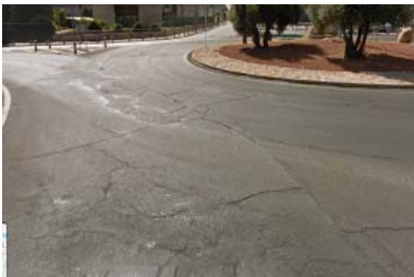
Foto 3. Glorieta con fisuras.
