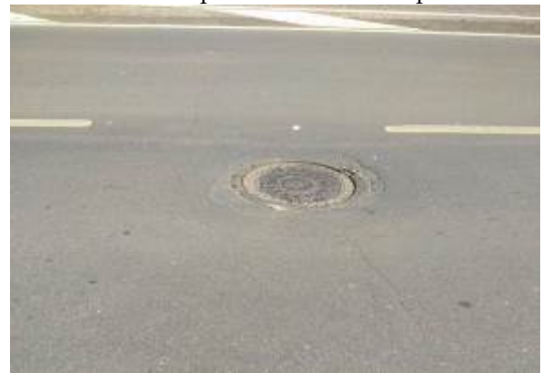
Foto 21. Arqueta de saneamiento.
