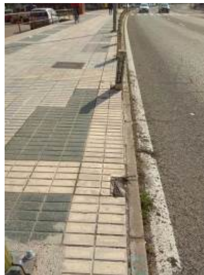
Foto 39. Bolardos en mal estado.
