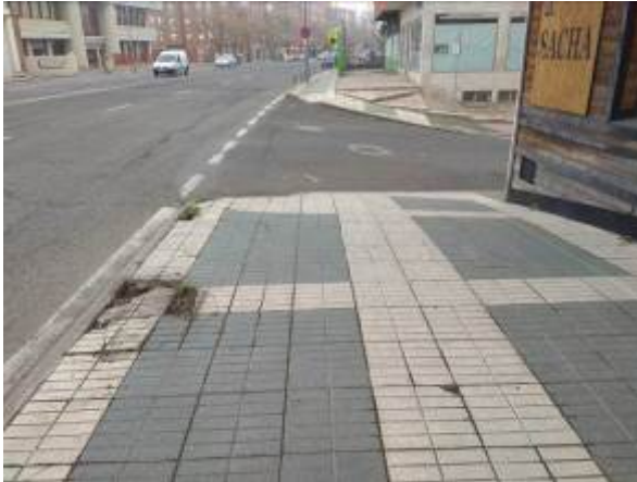
Foto 28. Baldosas en mal estado.
