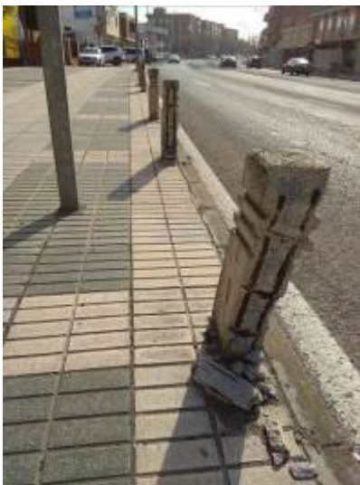
Foto 38. Bolardos en mal estado.
