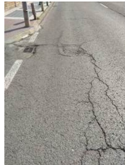
Foto 14. Posible tapa de saneamiento cegada.
