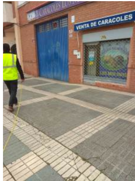
Foto 29. Zona de baldosas partidas
