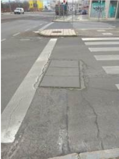
Foto 1. Tapas de instalación eléctrica.
