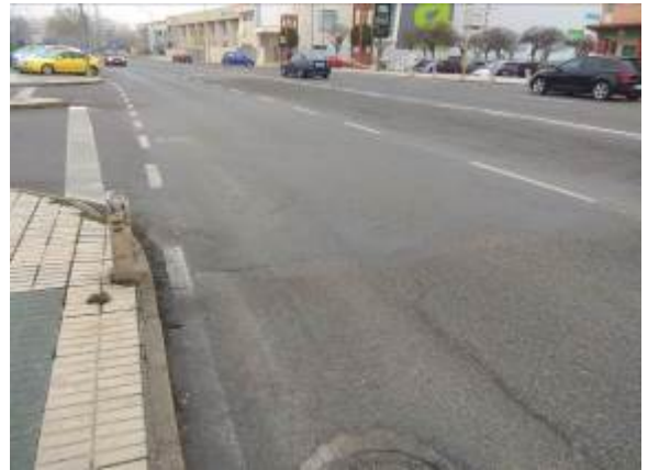
Foto 2. Zona de cambio de asfalto.
