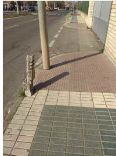
Foto 25. Discontinuidad en acerado
