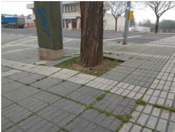
Foto 30. Acerado levantado por raíces.
