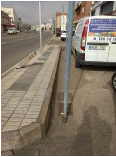
Foto 36. Bolardos en mal estado.
