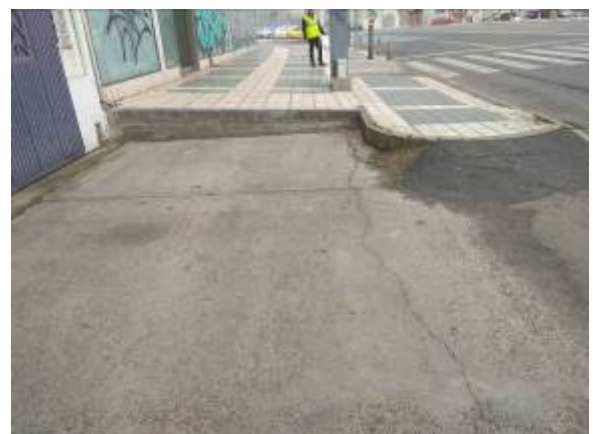
Foto 23. A Discontinuidad en acerado.
