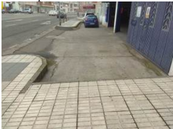
Foto 22. Discontinuidad en acerado.
