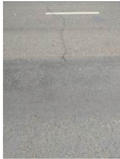
Foto 12. Fisura transversal en conexión.
