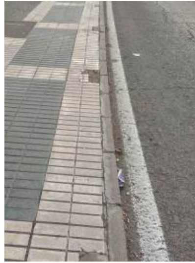
Foto 37. Zona con ausencia de bolardos.
