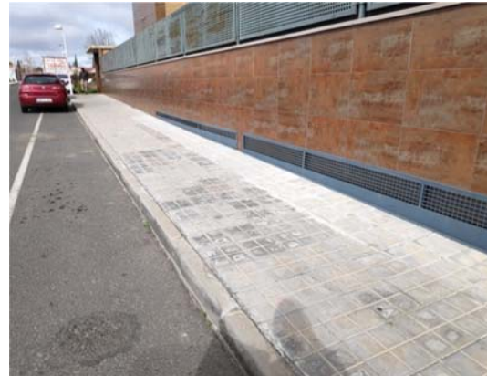
Foto 4: Baldosa existente y bordillo en buen estado
