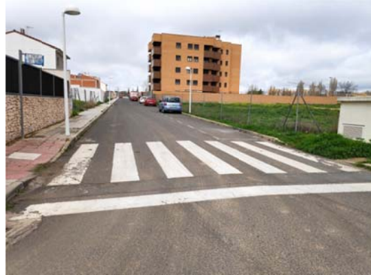
Foto 2: Falta de continuidad en paso peatones
