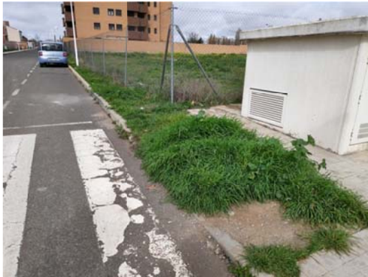
Foto 1: Inexistencia de acerado margen derecho
