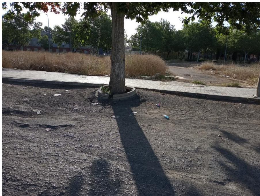
Foto 2: Estado calzada Ronda de Jaleo 1
