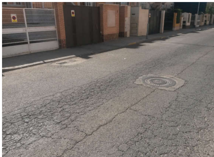
Roderas marcadas en el firme que presenta un aspecto muy cuarteado
