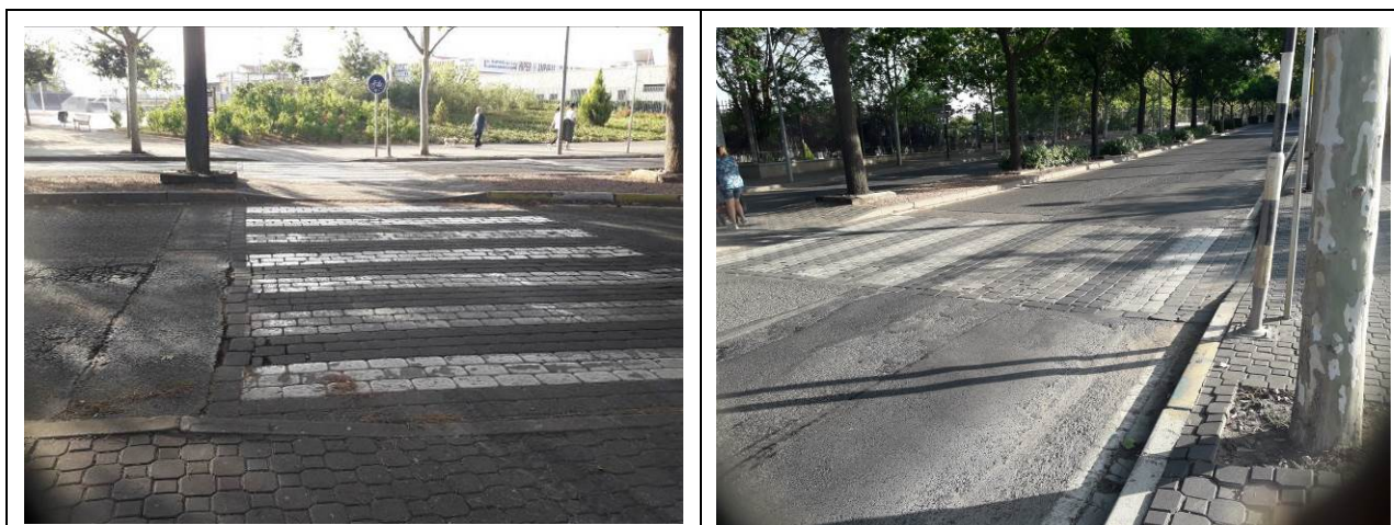
ESTADO ACTUAL DEL PASO DE PEATONES N. 5
